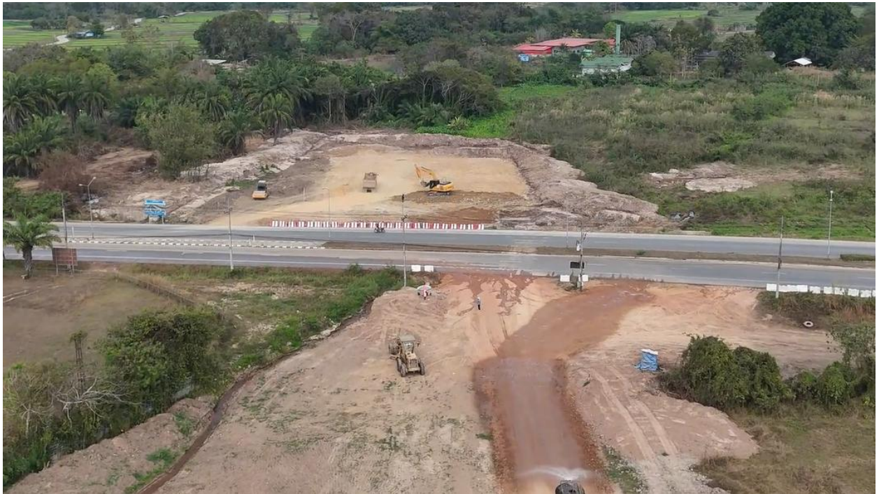
รูปที่ 5-8 ช่วง กม.5+319 จุดตัดกับทางหลวงหมายเลข 1157 บริเวณ กม.2+275 (พื้นที่ก่อสร้างถนนสายแยก ทล.11 ถึง ทล.1 อ.เมือง จ.ลำปาง ตอนที่ 1 อยู่ระหว่างดำเนินการก่อสร้าง)
