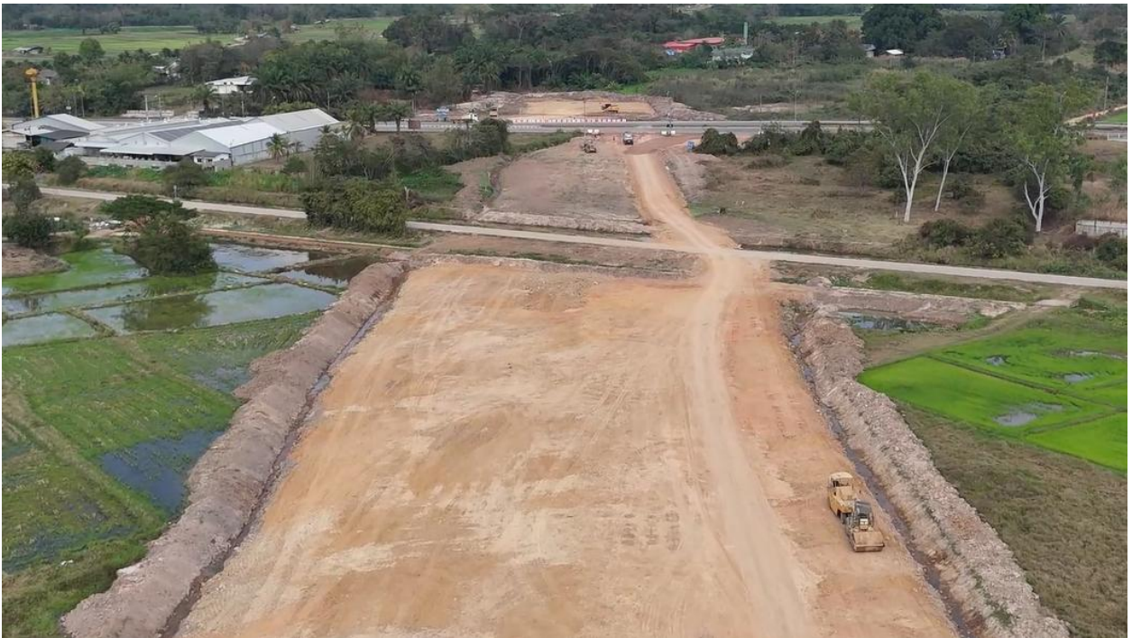
รูปที่ 5-7 ช่วง กม.5+000 (พื้นที่ก่อสร้างถนนสายแยก ทล.11 ถึง ทล.1 อ.เมือง จ.ลำปาง ตอนที่ 1 อยู่ระหว่างดำเนินการก่อสร้าง)
