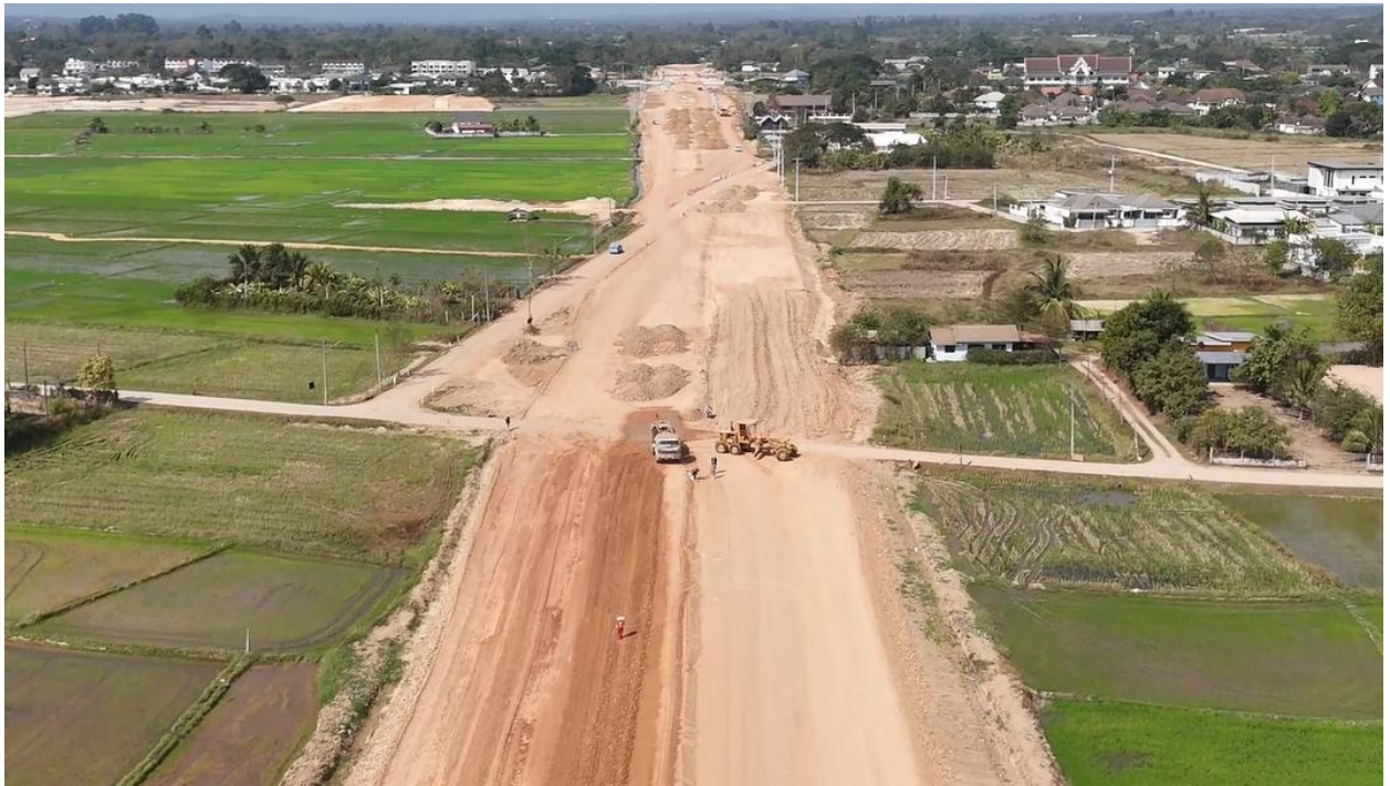
รูปที่ 5-4 ช่วง กม.2+000 (พื้นที่ก่อสร้างถนนสายแยก ทล.11 ถึง ทล.1 อ.เมือง จ.ลำปาง ตอนที่ 1 อยู่ระหว่างดำเนินการก่อสร้าง)
