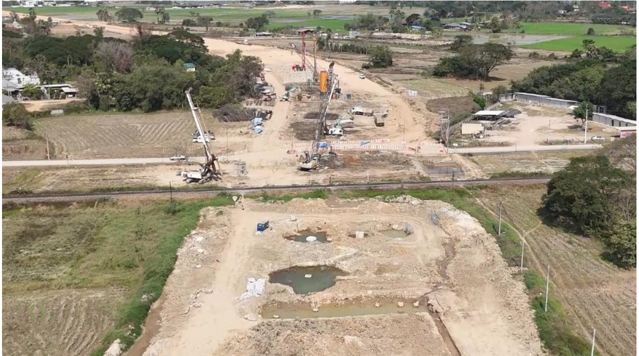
รูปที่ 5-2 ช่วง กม.0+687 จุดตัดกับทางรถไฟ (พื้นที่ก่อสร้างถนนสายแยก ทล.11 ถึง ทล.1 อ.เมือง จ.ลำปาง ตอนที่ 1 อยู่ระหว่างดำเนินการก่อสร้าง)
