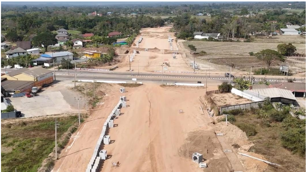
รูปที่ 5-5 ช่วง กม.2+930 จุดตัดกับทางหลวงหมายเลข 1039 บริเวณ กม.6+269 (พื้นที่ก่อสร้างถนนสายแยก ทล.11 ถึง ทล.1 อ.เมือง จ.ลำปาง ตอนที่ 1 อยู่ระหว่างดำเนินการก่อสร้าง)
